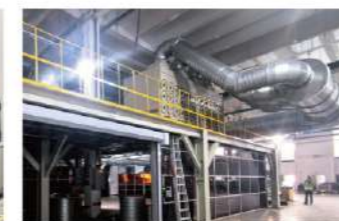
中央集塵・防爆システム
