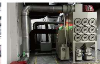
中央集塵・防爆システム
